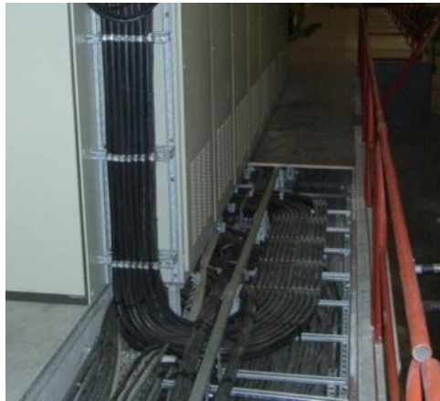
Рис. II-32 Кабели и кабельные полки
